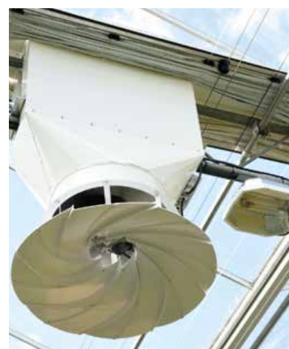
Nivolution is een systeem met twee ventilatoren, die een eind uit elkaar hangen.
